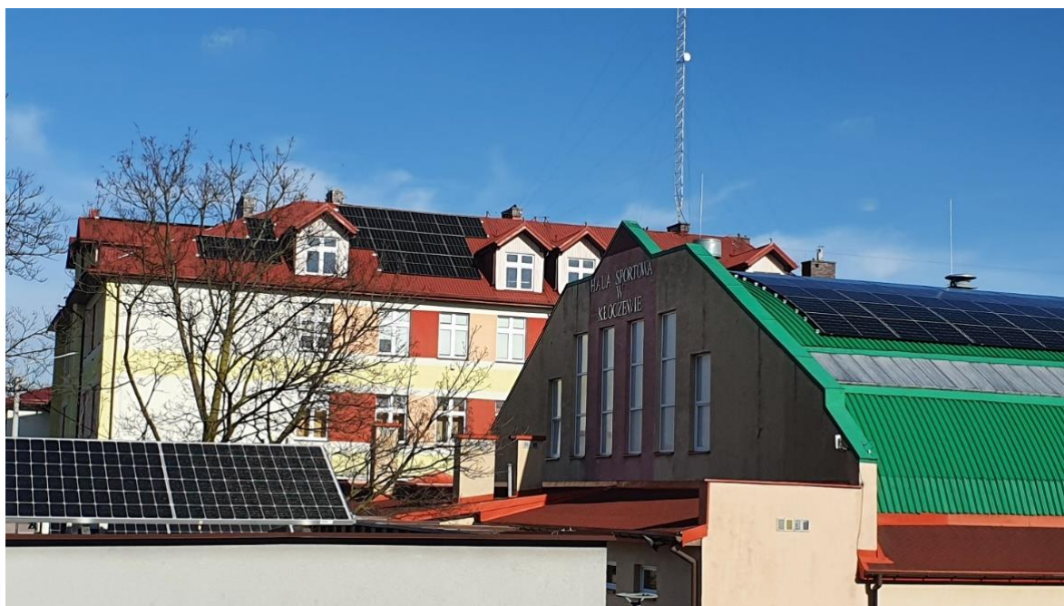
Instalacje FV na budynku użyteczności publicznej – SP Kłoczew
